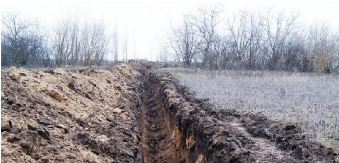
Рисунок 8. Зруйнована зрошувальна мережа в Придунайському регіоні
